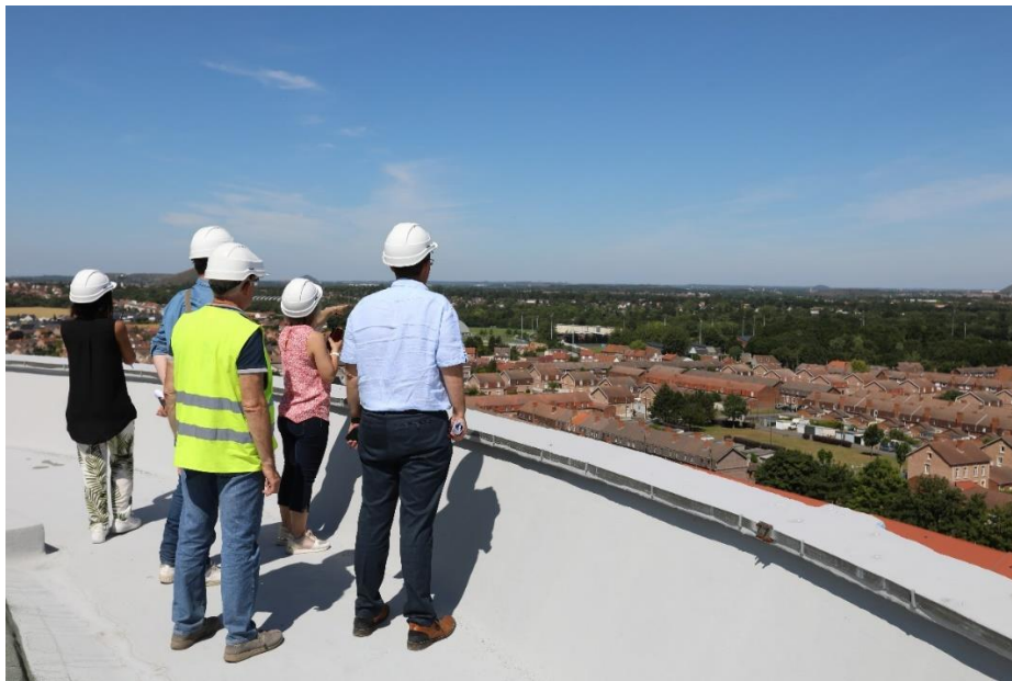
Vue du sommet du nouveau château d'eau communautaire en construction. Zone d'activité des Alouettes - Bully-les-Mines, CALL, février 2020
